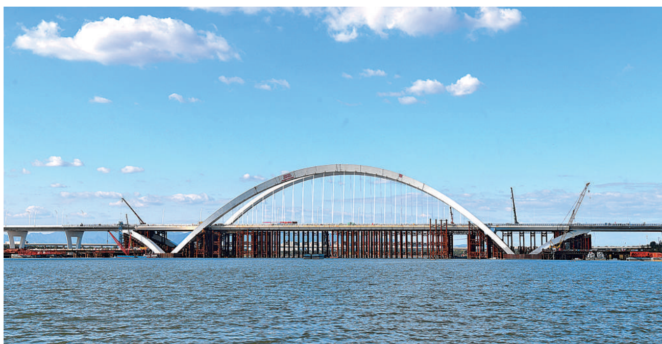
近日,位于北京永定河上的京雄大桥完成全桥吊杆安装张拉,进入桥下支架拆除及桥面铺装阶段,为京雄高速公路(北京段)年内全线通车奠定了基础。图为建设中的京雄大桥。孙立君摄(影像中国)
